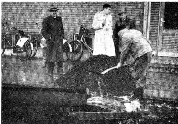
1 1/4 tons rust fra en 150 mm ledning i Storegade, ledningsstykket var 225 m langt.
